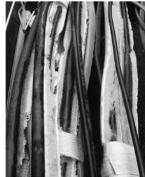
冷媒配管の断熱材がボロボロになっている。
